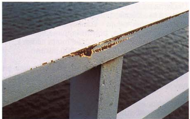
Kuva 9. Ruostunut naarmu kaiteen yläjohteessa.
