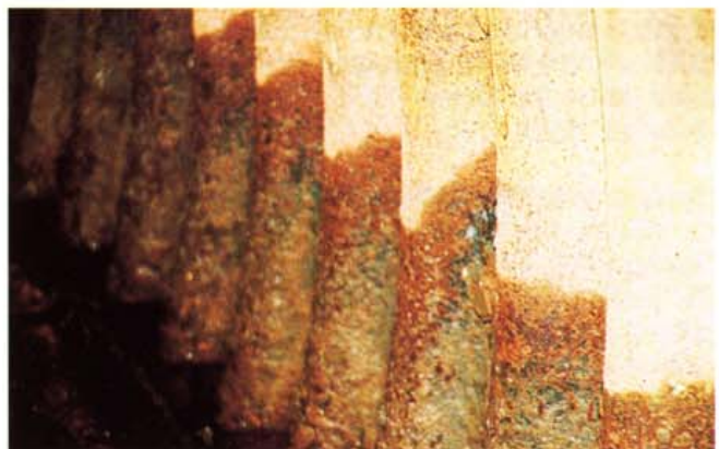
Kuva 10. Vedenpinnan vaikutusalueelta ruostunut teräsputki.
