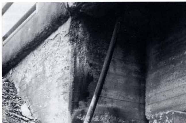
Kuva 8. Tippunokan puuttuminen on aiheuttanut siipimuurin rapautumisen.
