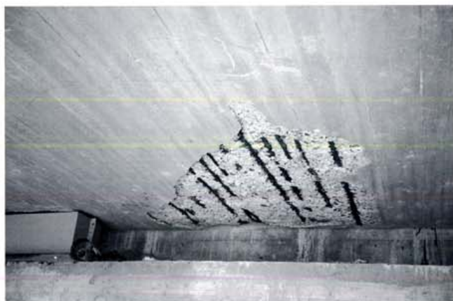
Kuva 10. Raudoituksen betonipeite on leikkautunut irti, kun kloridipitoinen vesi on päässyt leviämään
