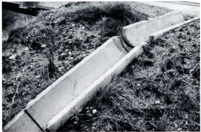
Kuva 7. Pintavesikouru on sortumassa eroosioaurion vuoksi.
