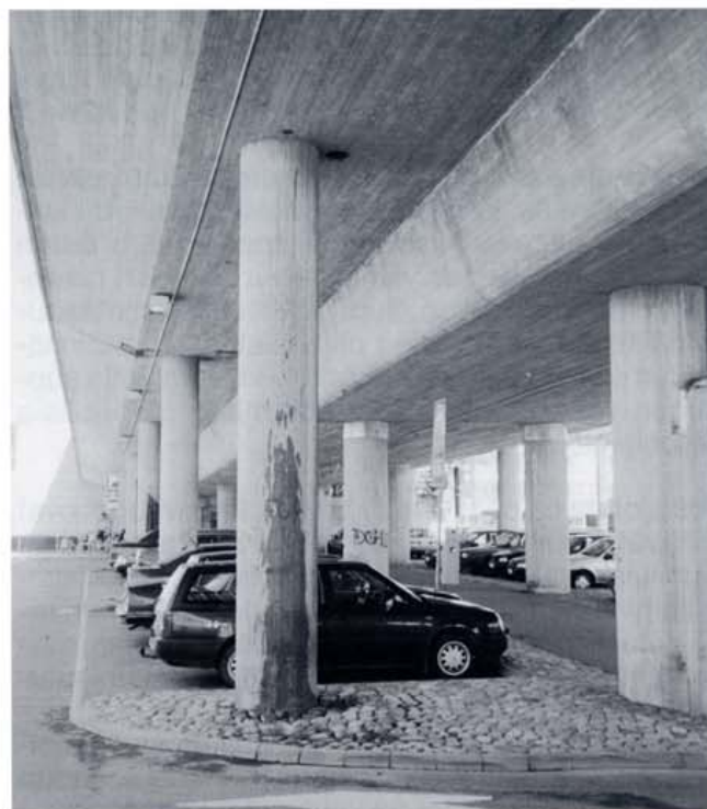
Kuva 11. Syöksytorven jatkoputki puuttuu, jolloin kloridipitoinen vesi roiskuu pilarin pinnalle.
