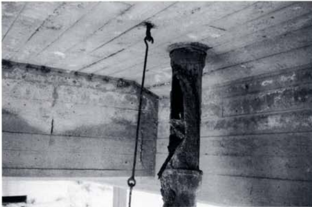
Kuva 5. Syöksytorven jatkoputkeen jäänyt vesi on rikkonut putken.
