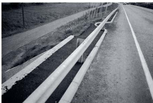
Kuva 1. Tehokas pintavesien ohjausjärjestelmä.
