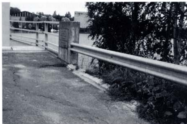
Kuva 12. Eroosioaurion aiheuttama painuma.
