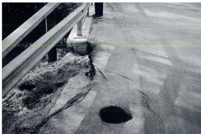
Kuva 3. Liikenneturvallisuutta vaarantava reikä on syntynyt puutteellisen kuivatusjärjestelmän takia.
