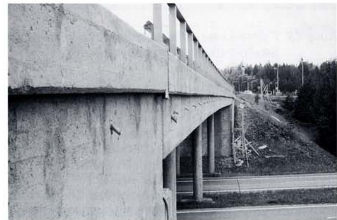
Kuva 41. Reunapalkin sivusta kaidepylväiden juuriin porattuihin reikiin liimatut tippuputket.
