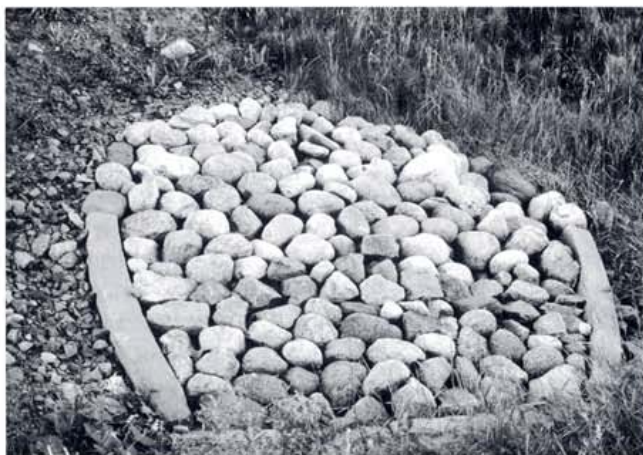
Kuva 37. Kivisilmä syöksytorven alla.
