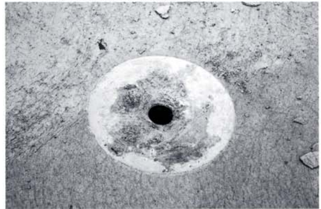
Kuva 40. Suppilolla varustetun tippuputken yläpää.
