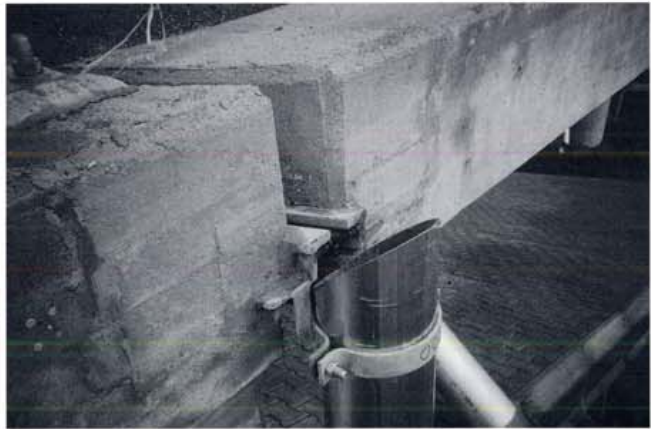
Kuva 22. Syöksytorvi liikuntasaumalaitteen päässä.
