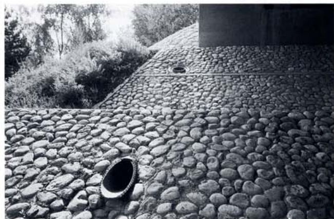
Kuva 24. Syöksytorvesta purkautuvat vedet on johdettu pintavesiputkella sivuojaan.
