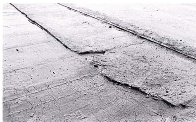
Kuva 9. Vanhat eristyskermit, joiden tukikerroksena on lasikangas, ovat usein täysin hapertuneet sillan reunoissa.
