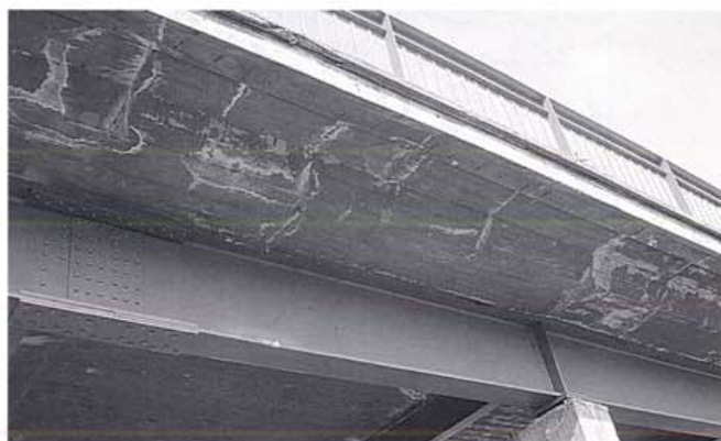
Kuva 7. Vuotavat halkeamat, kalkkipuikot ja kalkkiläiskät ovat merkkejä laajoista vedeneristysten vaurioista.
