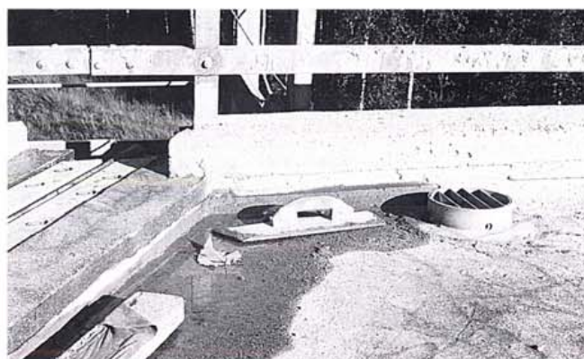
Kuva 11. Vesi ei saa lammikoitua kansilaatalle.
