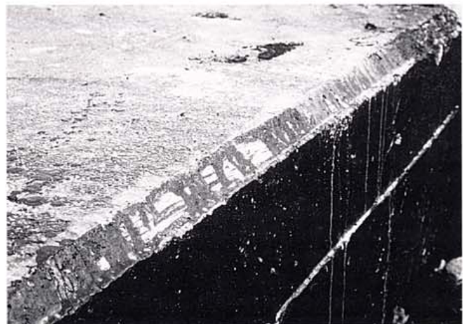
Kuva 32. Terävät särmät rikkovat vedeneristyksen.
