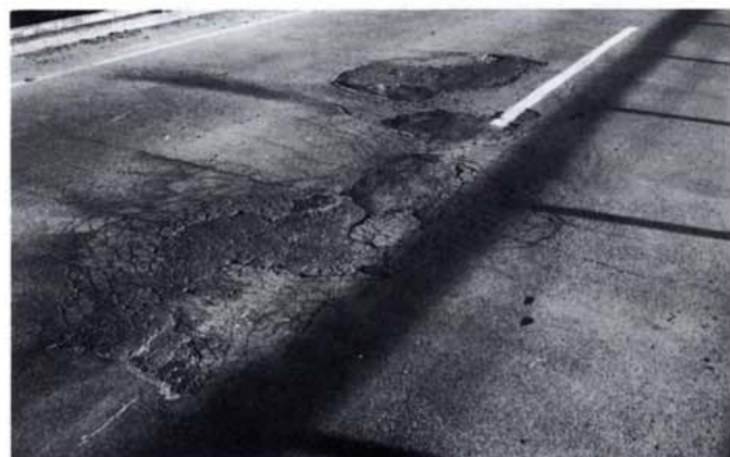
Kuva 11. Verkkohalkeamia ja purkautumia sillan päällysteessä
