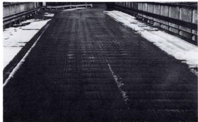
Kuva 9. Deformaatiota sillan valuasfalttipäällysteessä
