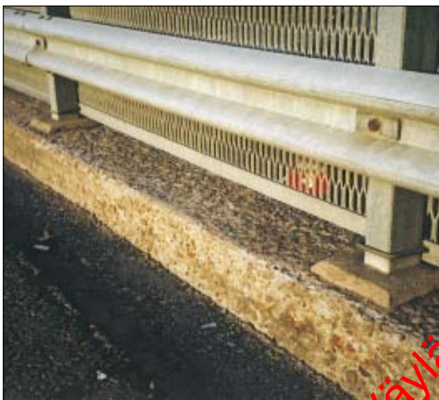
Kuva 1. Talvisuolauksen aiheuttamaa rapautumista reunapalkissa.
