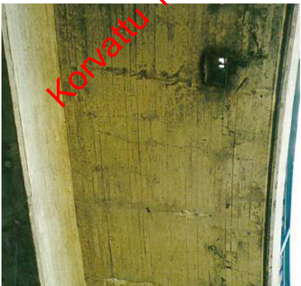
Kuva 2. Vesivuoto halkeaman kautta aiheuttaa seurausvaurioita.
