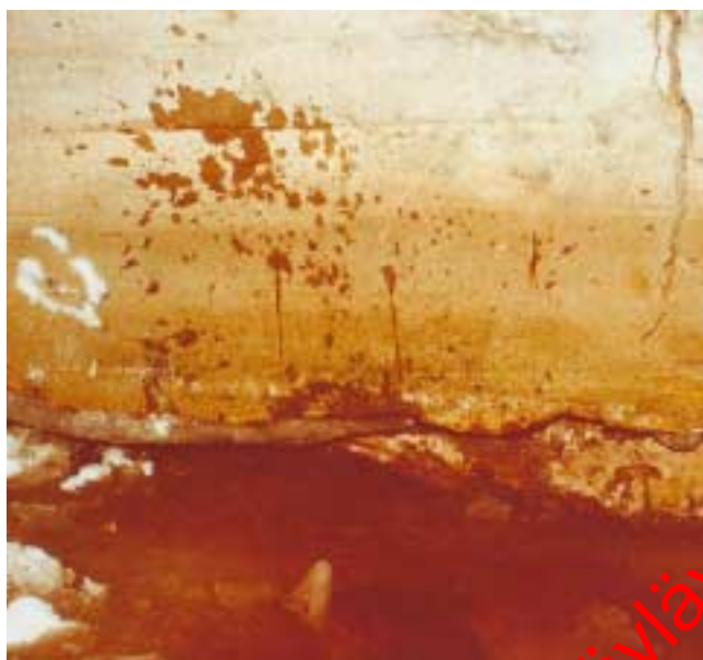
Kuva 1. Liian suuren maanpaineen aiheuttamia halkeamia.
