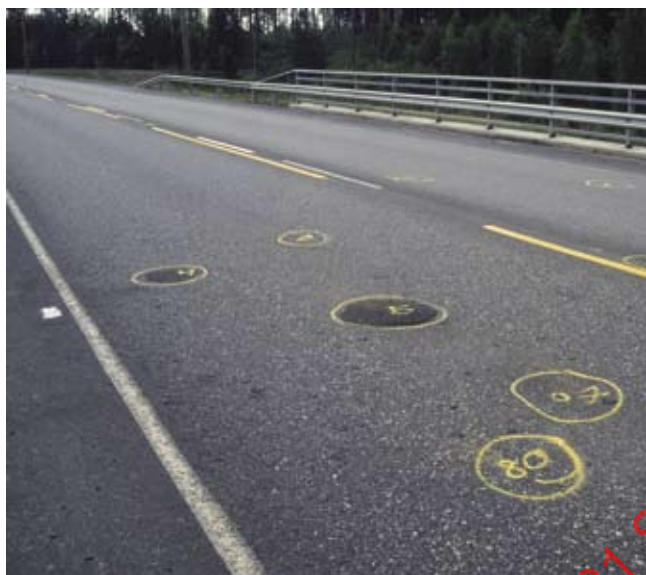
Kuva 1. Höyrystyneen kosteuden aiheuttamia kuplia päällysteessä.
