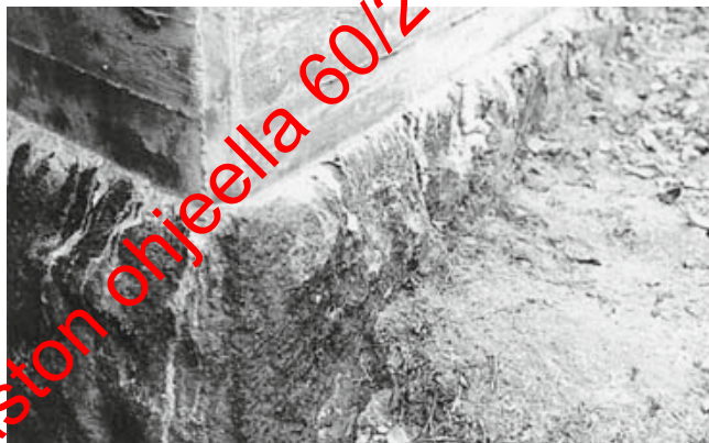
Kuva 9. Sementtiliimaa on valunut kivipinnoille.
