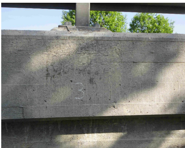
Kuva 2. Suojattavassa betonipinnassa ei saa olla syvää verkkohalkeilua. Kuvan pinnan voi vielä impregnoida. /Kuva Teknologian tutkimuskeskus VTT Oy/
