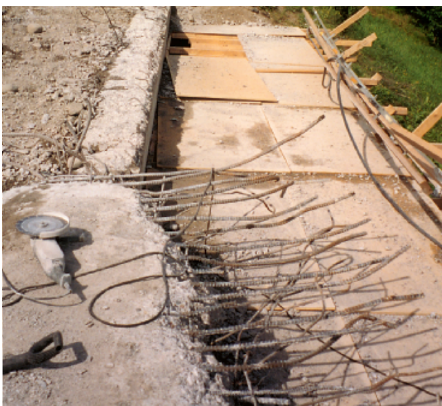
Kuva 2. Raudoitus vaurioituu usein taitamattoman piikkaustyön seurauksena.
