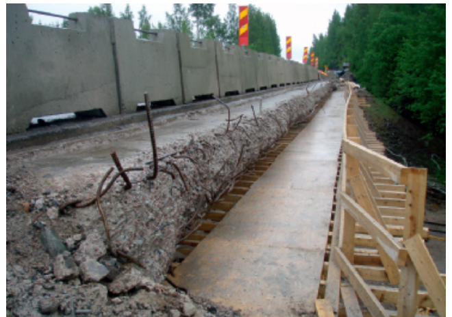
Kuva 3 Telineiden pitää antaa hyvä työskentelyalusta (raudoitus tuhottu piikattaessa!).
