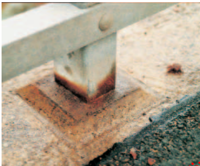
Kuva 1. Vaurioitunut kaidepylvään juuri.
