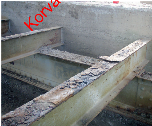
Kuva 2. Ruostuneet teräspalkkien ylälaipat.
