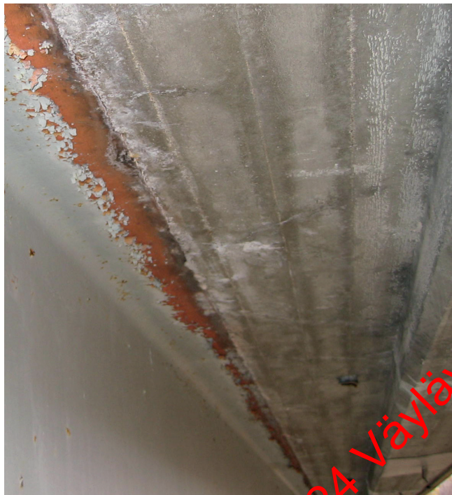
Kuva 1. Ylälaipan virheellisestä suojauksesta johtuva maalipinnoitteen vaurio.
