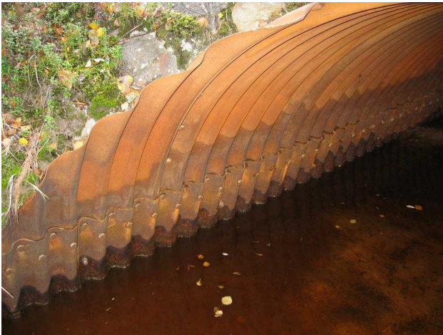
Kuva 1. Pahoin ruostunut teräsputkisilta. (Vaurioluokka 3)
