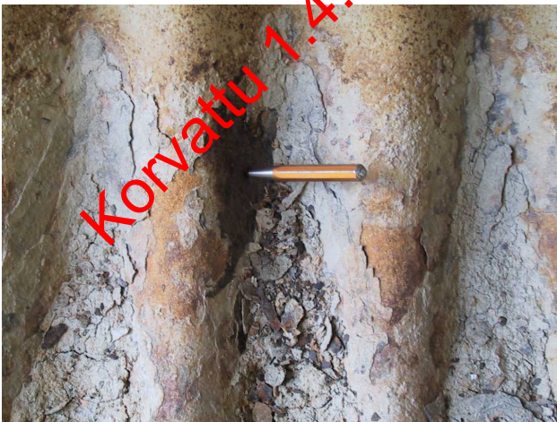
Kuva 2. Teräsputken vaurioluokitus tarkistetaan lopulliseksi piikkitestin perusteella. (Vaurioluokka 4)
