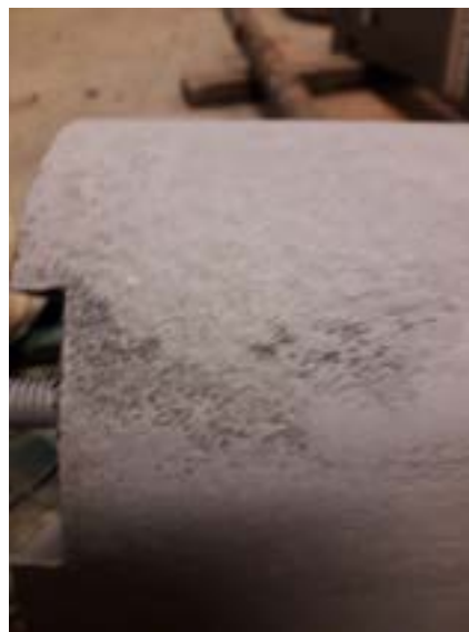
Kuva 17. Syöpymää rullan päässä.
