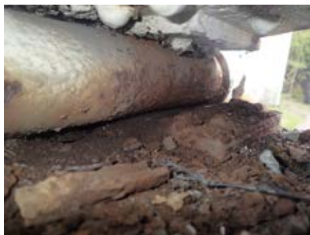
Kuva 16. Korjauskelvottomaksi syöpynyt rulla (Pajasaaren silta)
