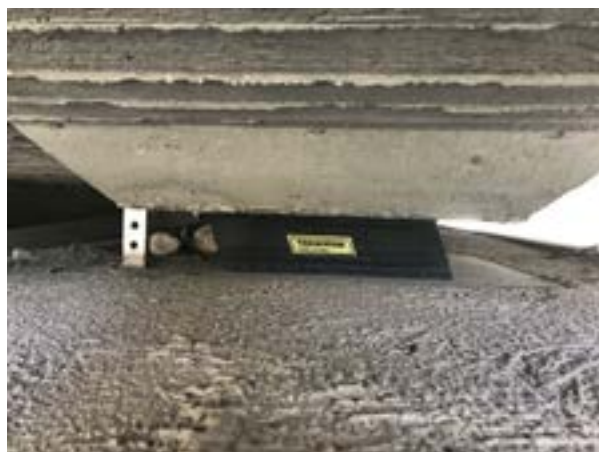
Kuva 3. Oikaisua tarvitseva kumilevylaakeri lämpötilassa +5°C. (U-4185 Hirvenojan AKS)
