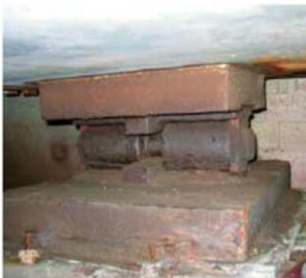
Kuva 4. Kiireellisesti huoltokäsittelyä vaativa laakeri.
