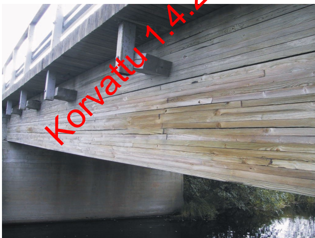
Kuva 2. Korjausta vaativia halkeamia ja liimasaumoja.
