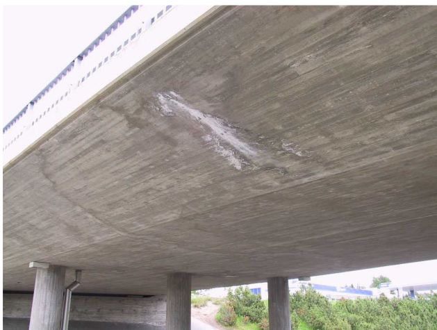
Kuva 1. Reunan vesivuoto purkautuu ulos halkeamasta.
