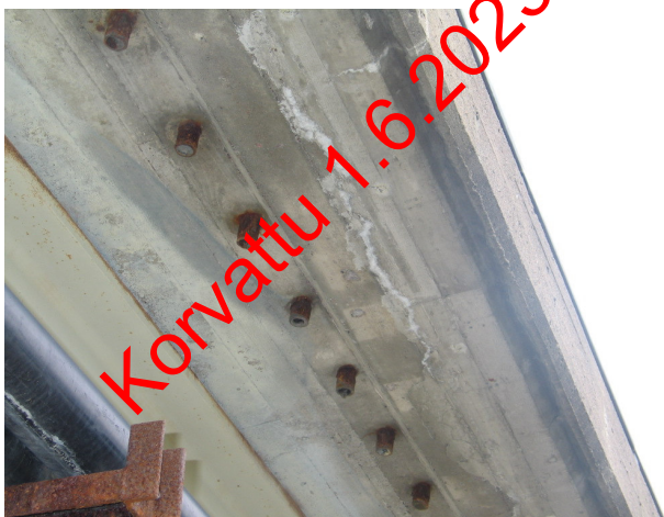
Kuva 2. Kuivatus ei toimi, vaikka tippuputkia on ohjeissa vaadittua enemmän.
