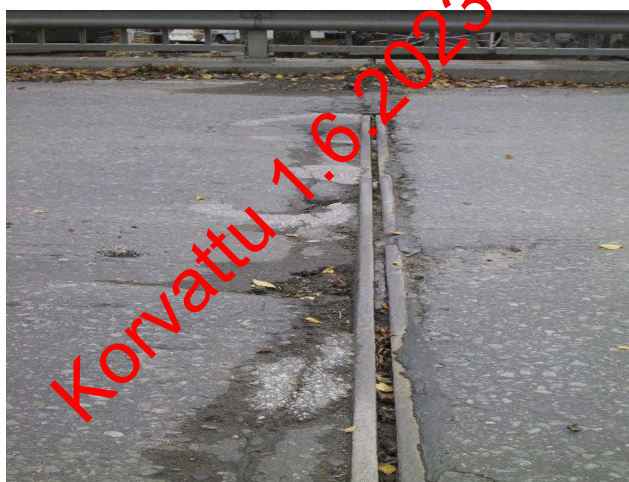
Kuva 2. Pahoin vaurioitunut päälyste liikuntasau- man vieressä.
