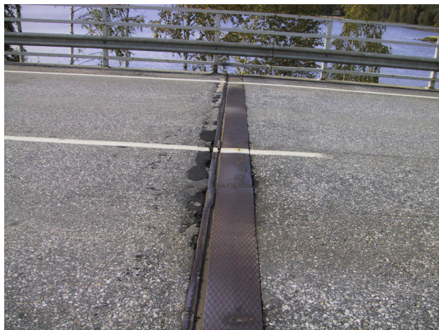
Kuva 1. Päälyste on purkautunut liikuntasaumalaitteen vierestä.
