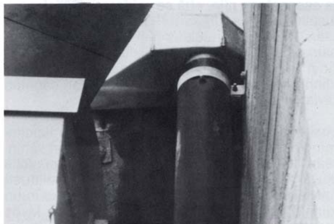
Kuva 13. Muovinen liikuntasaumalaitteen syöksytorvi
