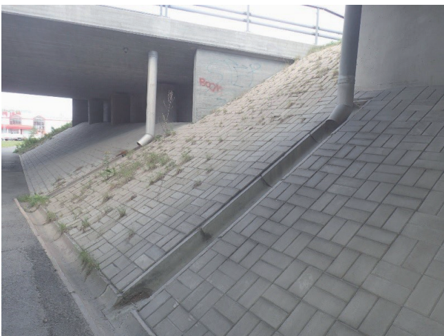
Kuva 3. Hulevesikourut etuluiskassa syöksytorven jatkeena.
