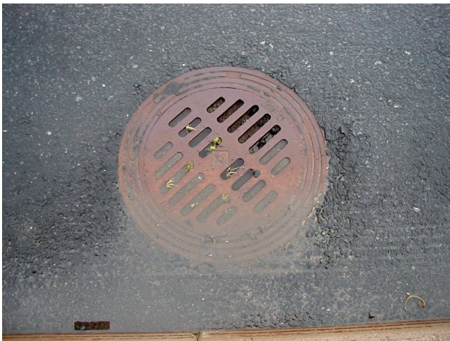
Kuva 2. Maa-aineksista täytynyt hulevesikaivo.
