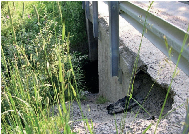
Kuva 1. Vakava eroosioaurio siipimuurin päässä.
