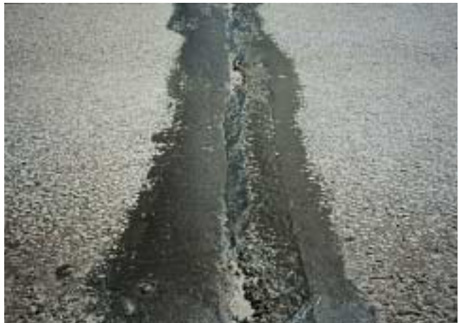
Kuva 3. Sauman pituussuuntaisen halkeaman syvyys ja syy on selvitettävä.
