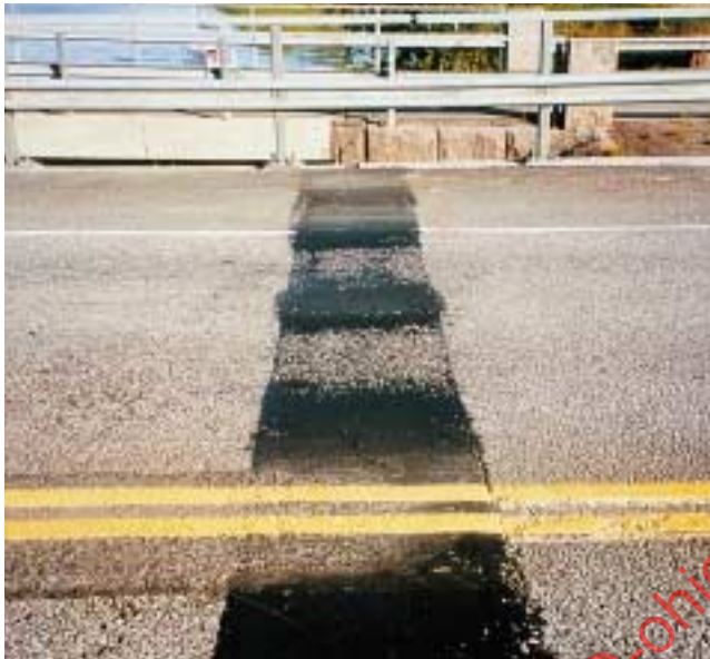
Kuva 1. Massaliikuntasauma on kulunut ajourien kohdilta.
