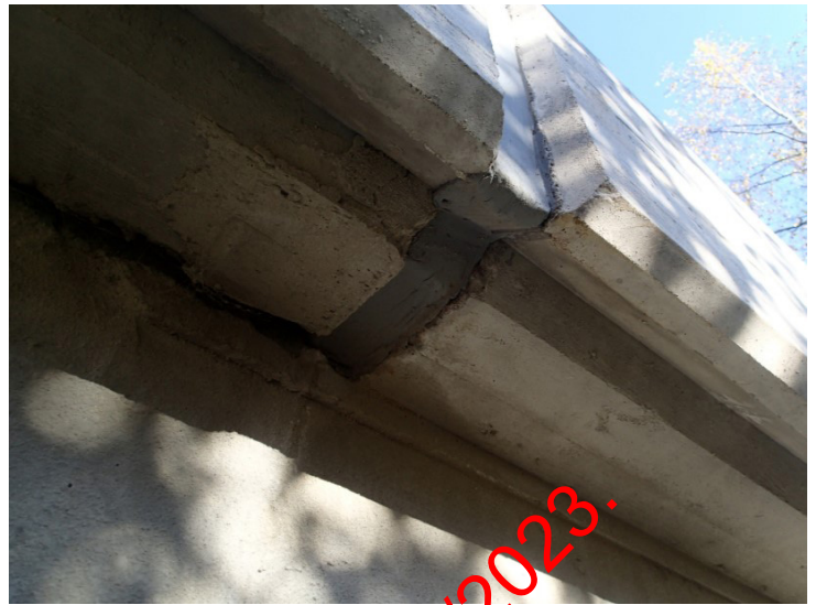
Kuva 9. Virheellisesti alapuoleltakin saumattu reunapalkki.
