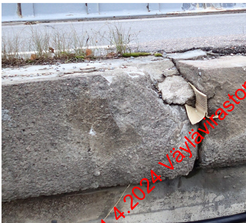
Kuva 2. Rapautuneet reunapalkit on korjattava ennen sauman tiivistämistä.
