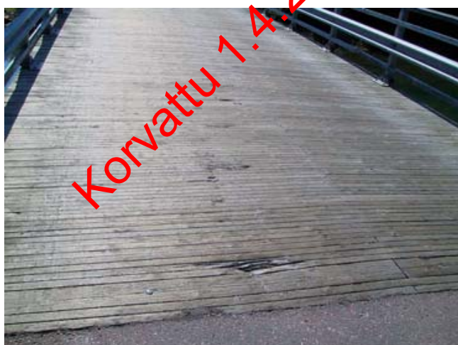
Kuva 2. Päällystyskelpoinen vaurioluokan 2 puukansi.
