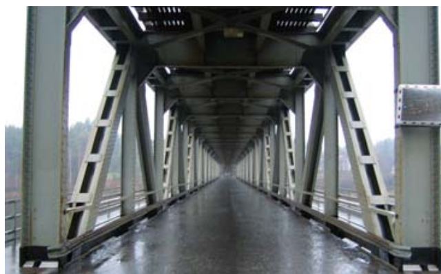
Kuva 4. Monielementtinen liikuntasaumalaite ja juotosbetonista valetut tukikaistat.
