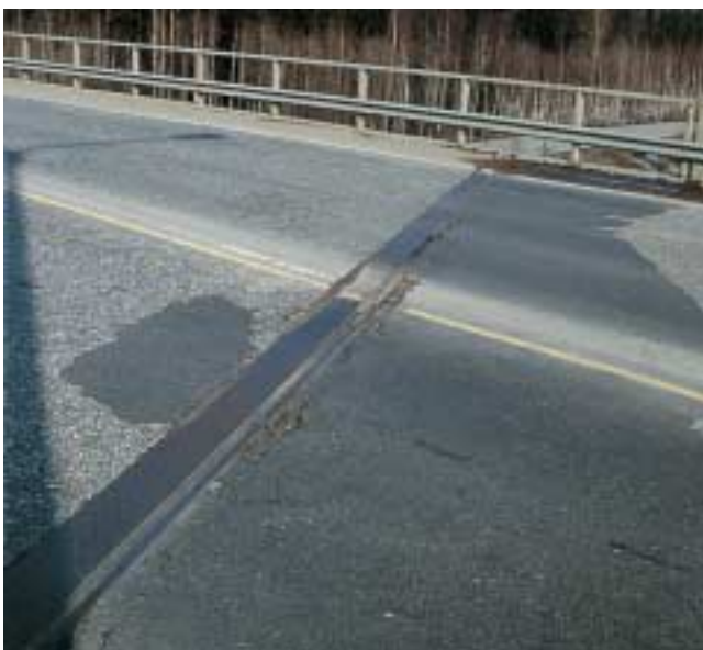
Kuva 2. Kynnys sillan ja penkereen rajassa aiheuttaa tarpeettomia iskuja siltarakenteille.
