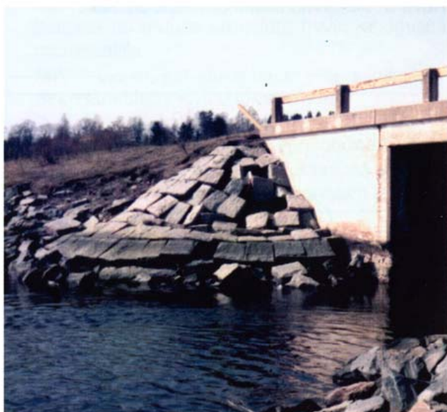
Kuva 1. Kiviheitokkeen eroosioaurion vuoksi sortunut keilaverhous.
