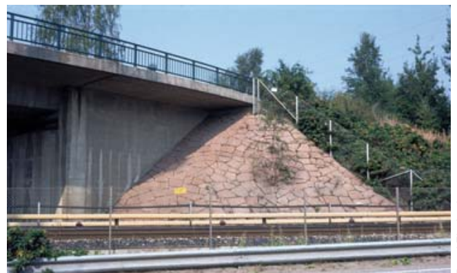
Kuva 8. Epäsäännöllisistä kivilaatoista tehty verkkoverhous.
