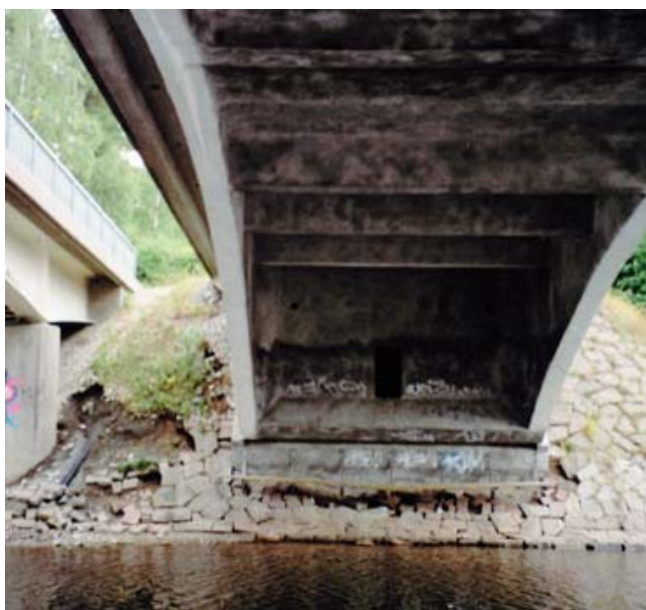
Kuva 2. Etuluiskan verhousta on purettu ilkivaltaisesti ja siltojen välinen verho on sortunut eroosiovaurion vuoksi.
