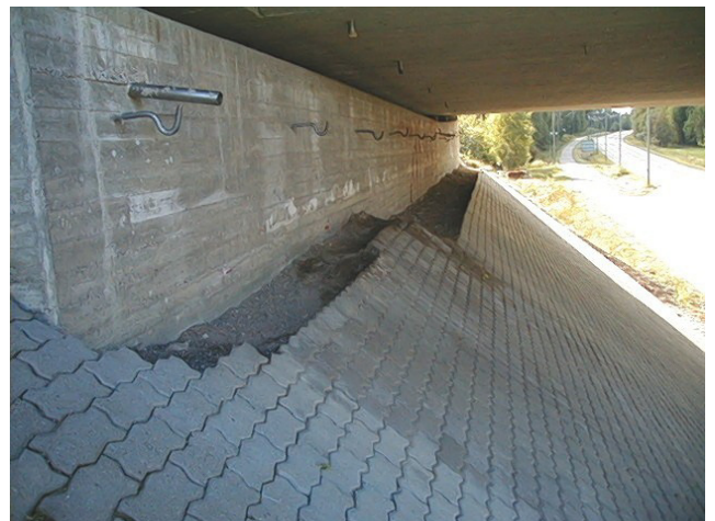
Kuva 6. Reunavahvennuksen puuttuessa betonikiviä on irrotettu runsaasti.
