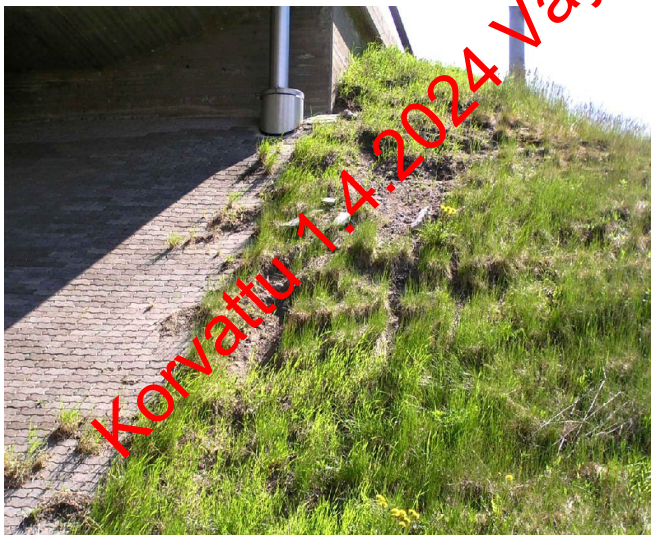
Kuva 2. Liikkuminen luiskassa vaurioittaa nurmiverhous- usta.
